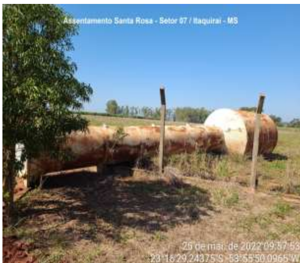
Foto 04 – Centro de Reservação do Setor 07
