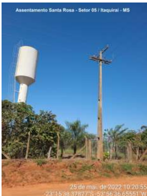
Foto 02 – Centro de reservação do Setor 05
