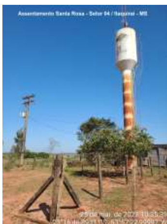
Foto 1: Centro de Reservação do Setor 04
