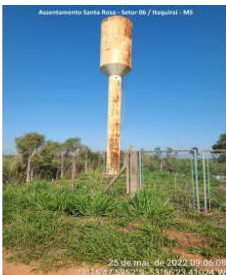
Foto 03 – Centro de Reservação do Setor 06
